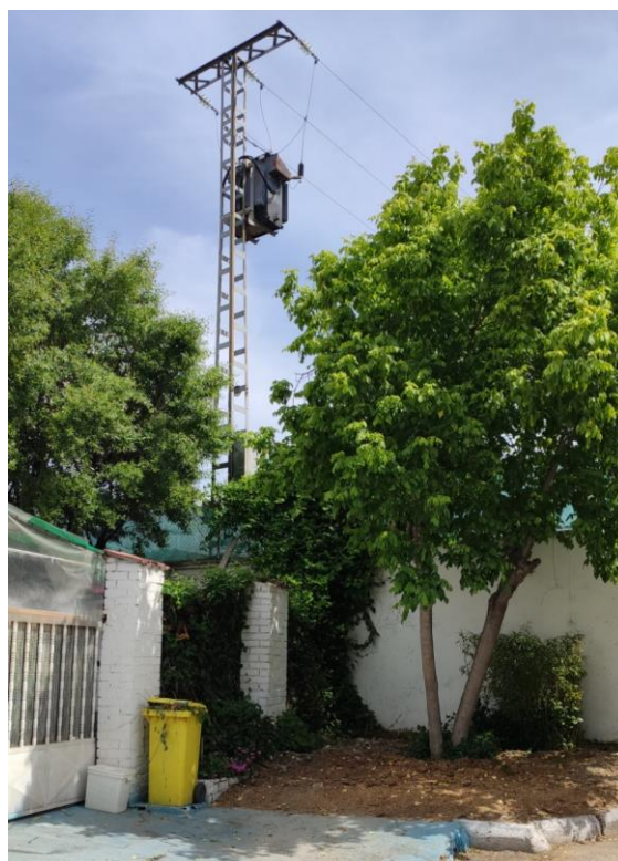
Ilustración 13. Centro de transformación aéreo situado al norte de la colonia. Fuente: Elaboración propia.
